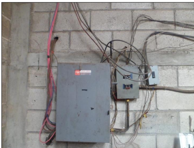
Figura 15. Instalaciones eléctricas en las áreas de trabajo
