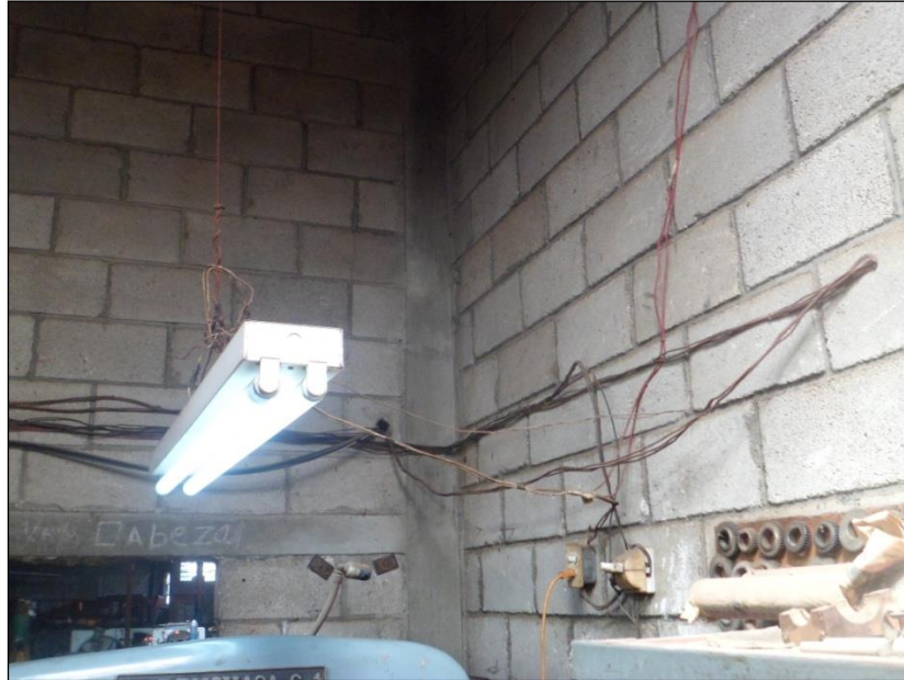
Figura 14. Iluminación fuera de especificaciones en las áreas de trabajo
