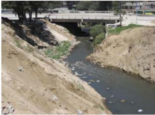
Figura 57. Socavación en la base de los taludes provocado por el cauce del río
