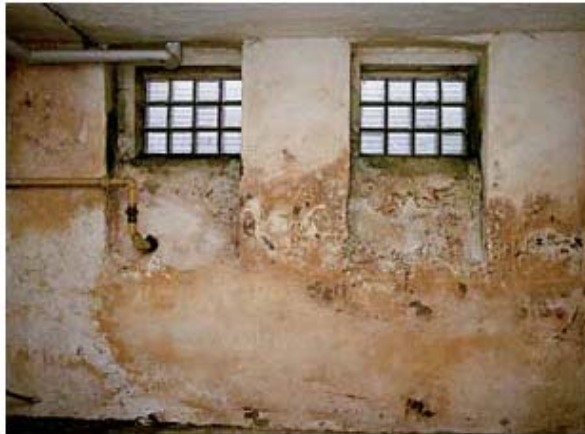
Figura 40. Muros afectados por humedad
