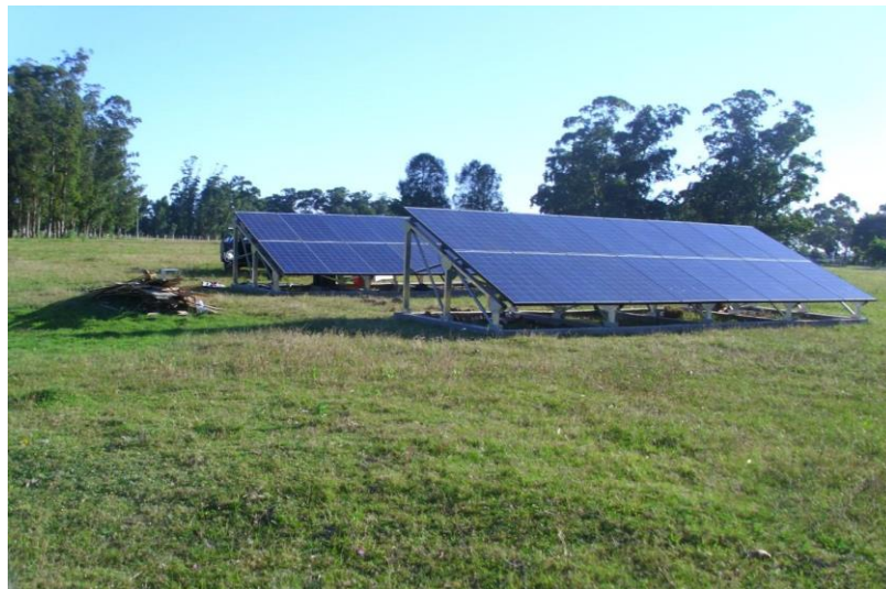
Figura 13. Conjunto de paneles solares fotovoltaicos
