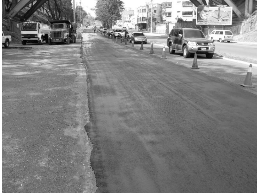
Figura 8. Línea de borde y alineamiento longitudinal no aceptable
