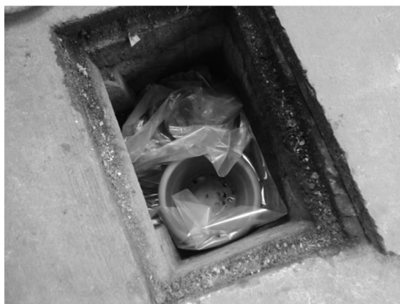
Figura 43. Acceso a pozo de absorción
