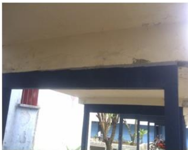
Figura 27. Techo con grietas con desprendimiento de material
