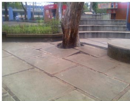
Figura 44. Grietas en el piso
