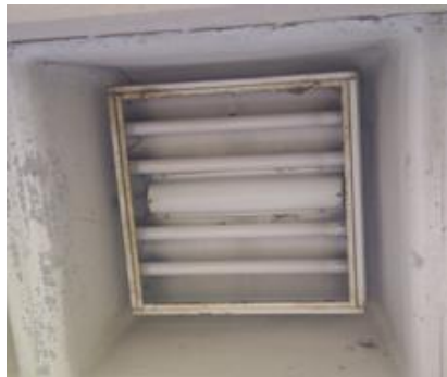
Figura 51. Lámpara dañada sin protección
