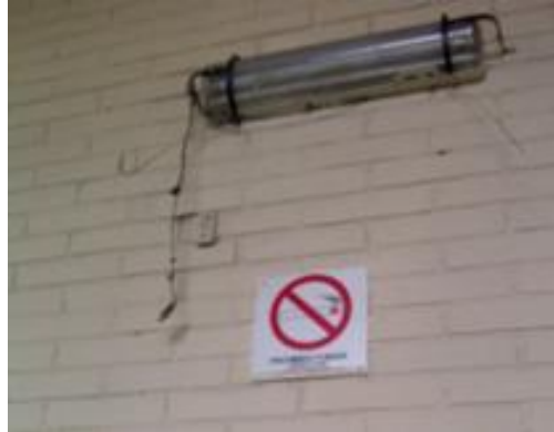
Figura 40. Lámparas de emergencia desconectadas
