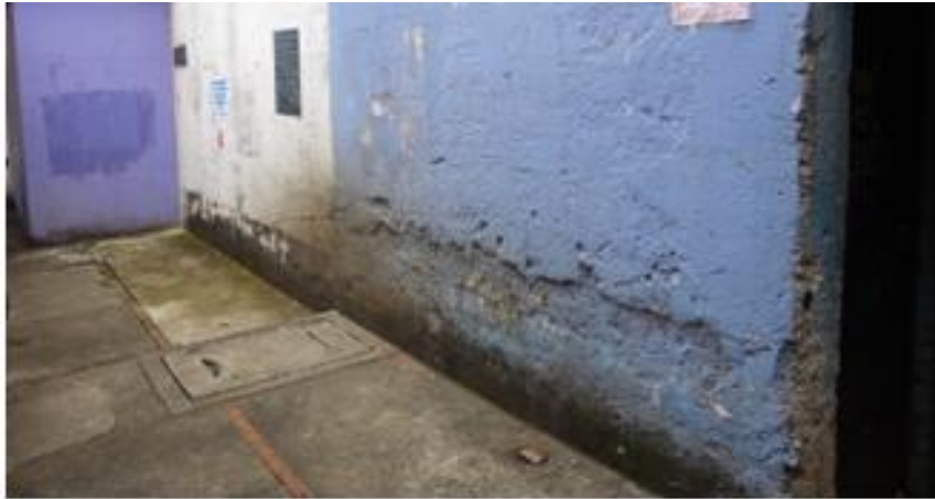
Figura 56. Deterioro de paredes y humedad
