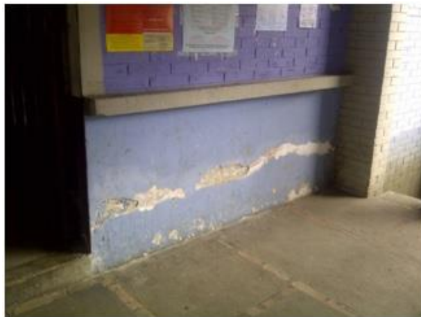
Figura 25. Pared con grietas con desprendimiento de material
