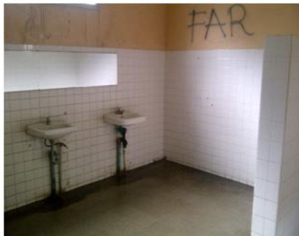
Figura 22. Lavamanos en mal estado
