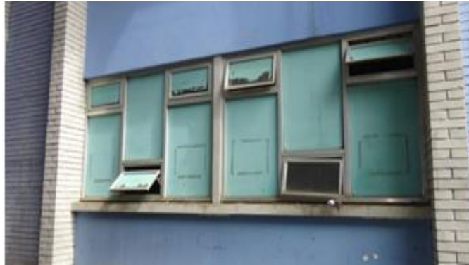
Figura 54. Ventanas con vidrios rotos
