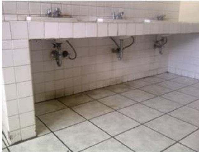
Figura 6. Lavamanos en mal estado
