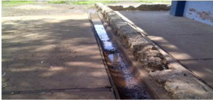
Figura 49. Canal de agua sin rejilla
