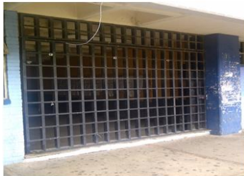
Figura 43. Salida de emergencia trasera del edificio cerrada
