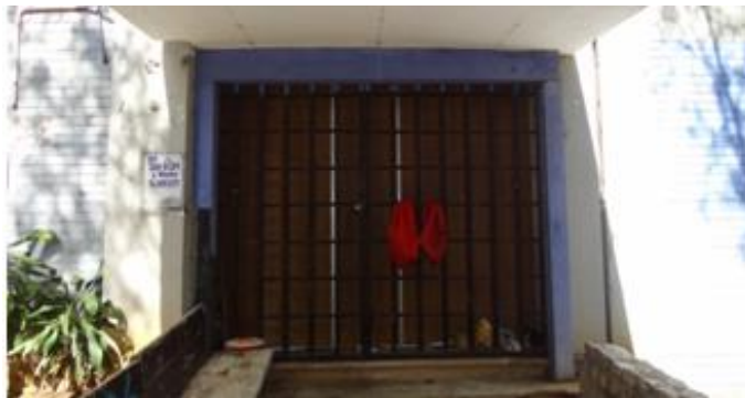
Figura 58. Salida de emergencia lateral del edificio cerrada
