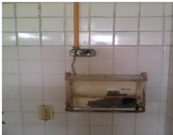
Figura 16. Secador de manos en mal estado
