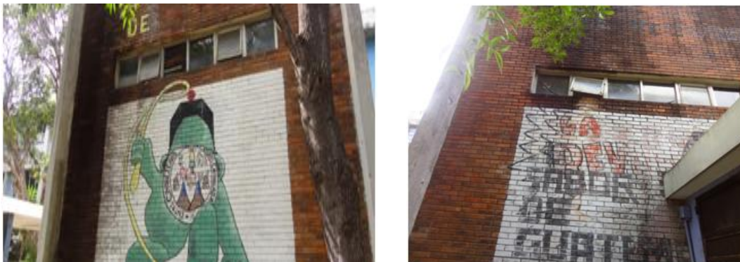
Figura 57. Filtración de líquidos en pared
