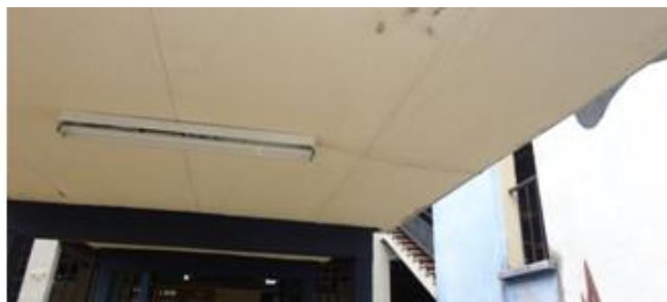
Figura 60. Lámpara en mal estado
