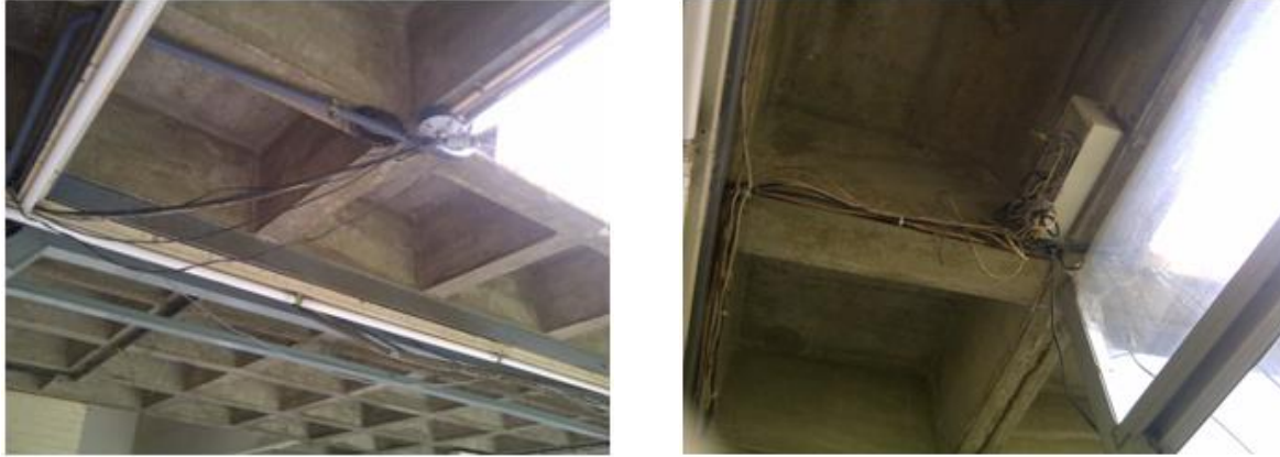
Figura 39. Cables eléctricos expuestos
