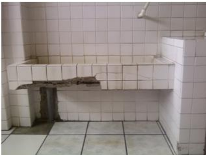
Figura 5. Mingitorios en mal estado, segundo nivel
