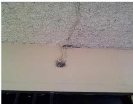
Figura 33. Cables eléctricos expuestos I
