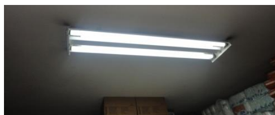
Figura 12. Luminarias actuales en el Departamento de Suministros
