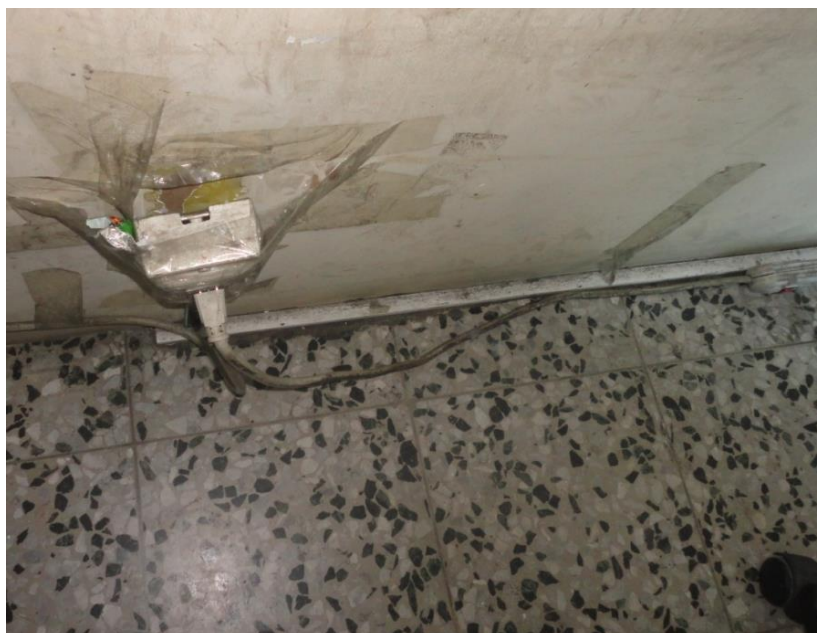
Figura 9. Instalaciones eléctricas en el área administrativa
