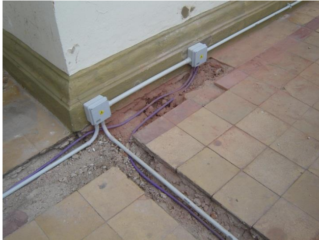
Figura 22. Instalación eléctrica expuesta
