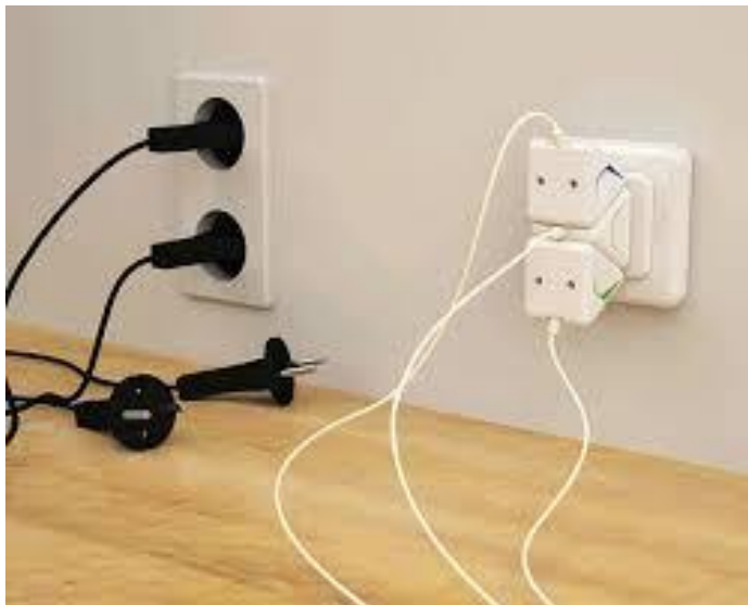
Figura 23. Instalación eléctrica no expuesta
