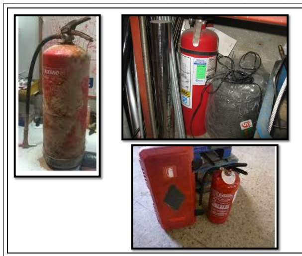
Figura 24. Ubicación actual de extintores
