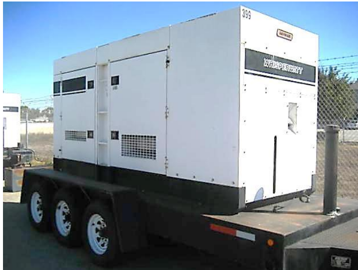
Figura 5. Generador de emergencia 300 KVA
