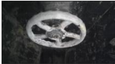
Figura 4. Llave de paso de mezclador de corta grasa
