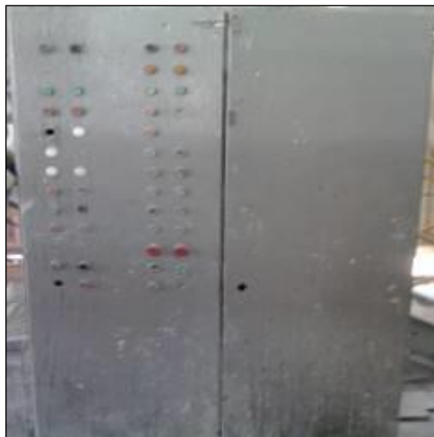
Figura 21. Panel de control de mezcladores
