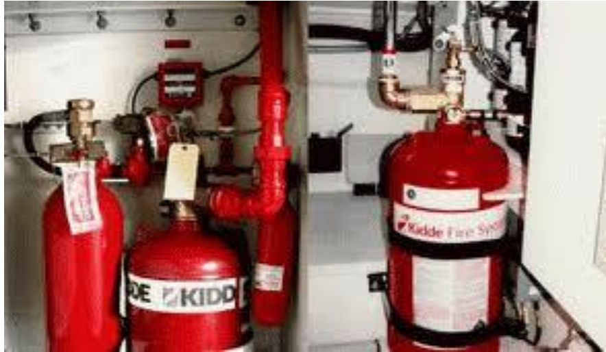
Figura 38. Sistema contra incendios
