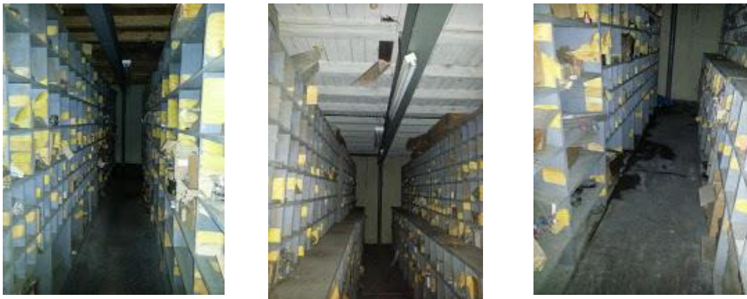
Figura 13. Falta de iluminación
