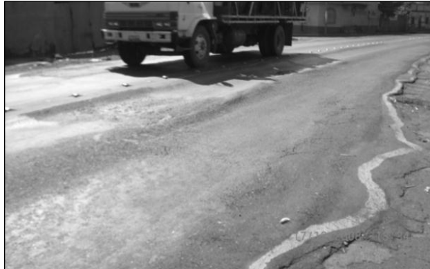
Figura 11. Fallas de ahuellamiento y corrimiento
