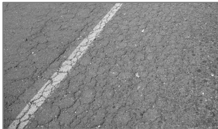
Figura 10. Fisuras piel de cocodrilo
