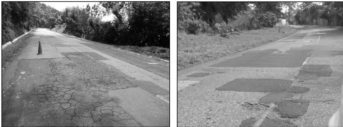
Figura 30. Bacheos realizados en la ruta
