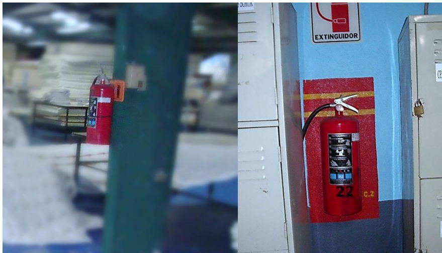
Figura 47. Extintores instalados en la planta de producción
