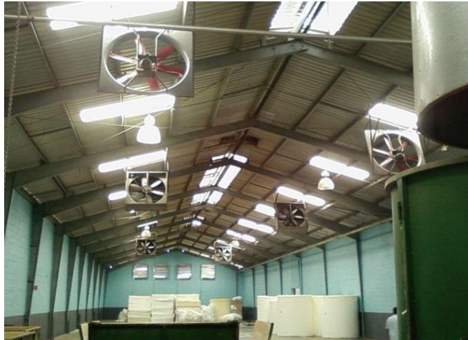
Figura 31. Área de enfriamiento
