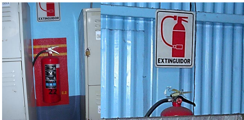
Figura 51. Señales instaladas en los equipos contra incendios, ubicados dentro de la planta de producción
