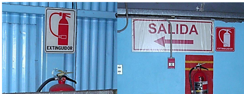
Figura 48. Señalización instalada para identificar ruta de salida y equipo contra incendios
