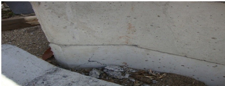
Figura 57. Fisuramiento en la primera placa del muro 2
