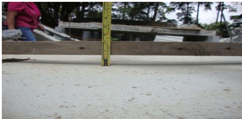
Figura 59. Deformación en la parte central de la losa
