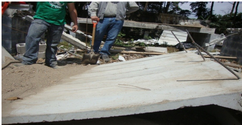
Figura 58. Deflexión de losa
