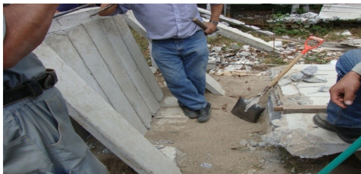
Figura 60. Falla de losa sobre el muro 2 a la izquierda
