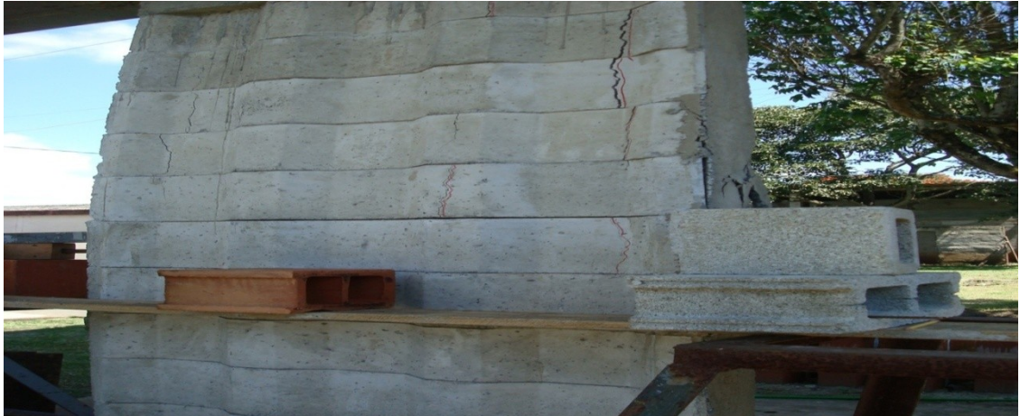
Figura 43. Falla en el muro tipo llave sin refuerzo
