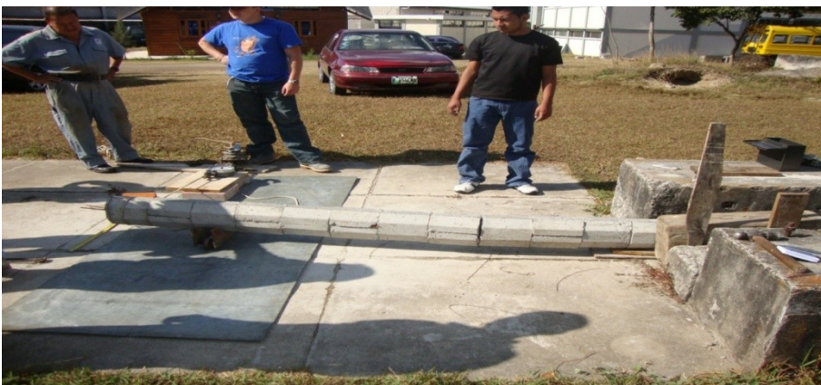
Figura 45. Falla de flexión en poste 2
