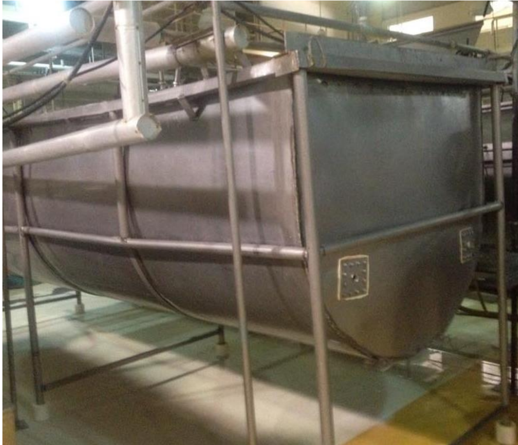
Figura 9. Tanque de capacidad de 8 000 litros
