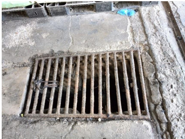
Figura 9. Rejilla para remoción de sólidos
