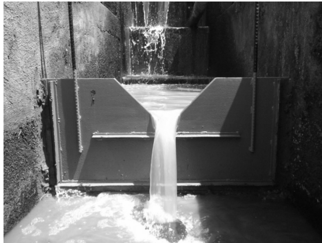
Figura 105. Vertederos en funcionamiento
