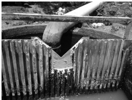
Figura 103. Vertedero instalado en lagunas facultativas
