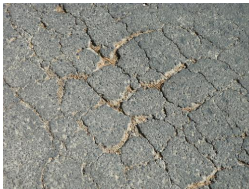
Figura 59. Est. 1+990, grietas en bloque severidad alta
