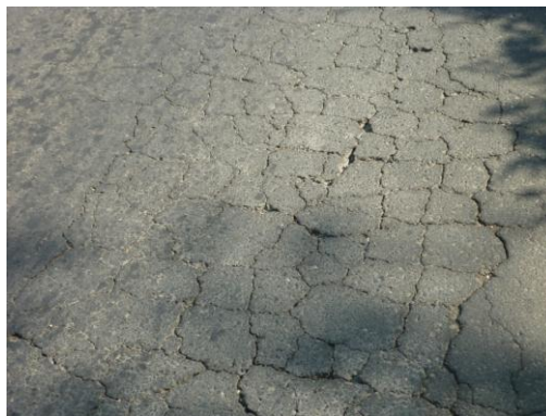
Figura 55. Est. 1+550, grietas en bloque severidad media
