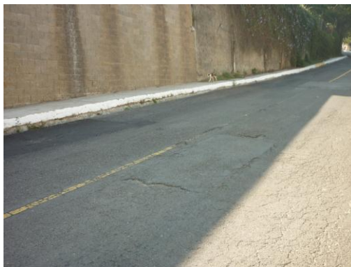
Figura 49. Est. 0+390, parches severidad media
