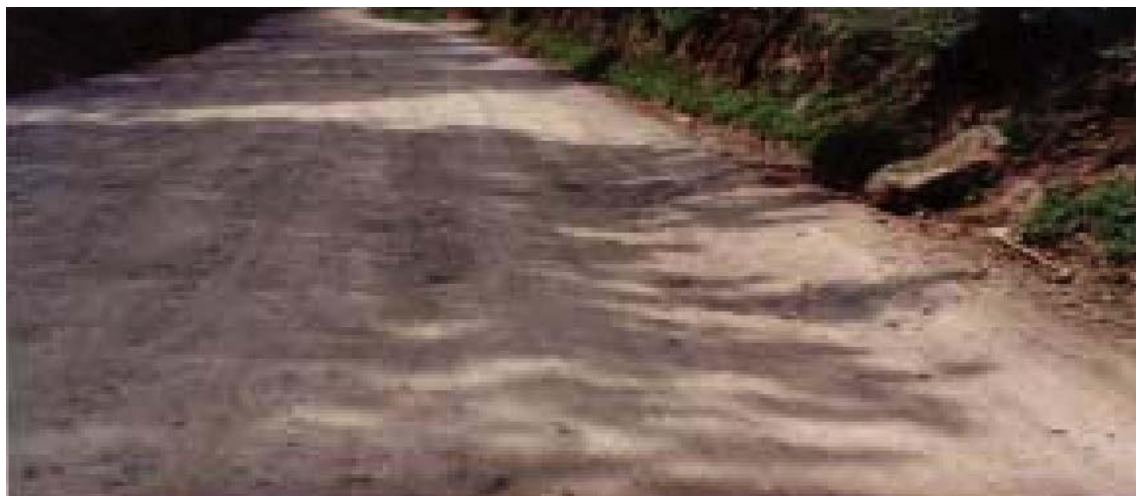
Figura 32. Ahuellamientos severidad alta
