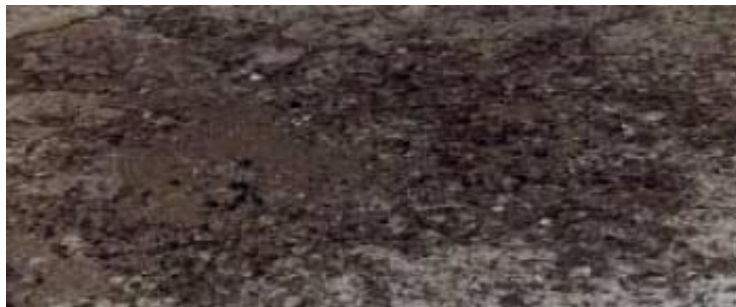
Figura 24. Descascaramiento severidad alta
