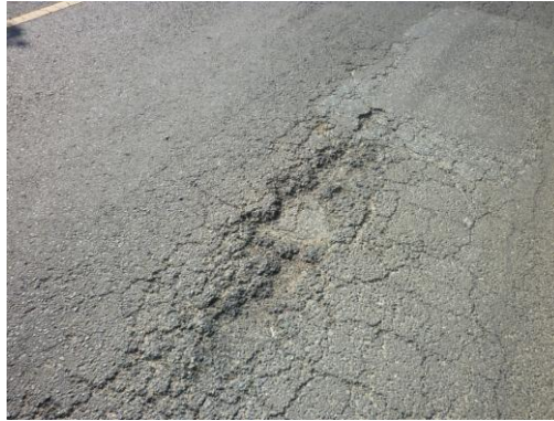
Figura 46. Est. 0+080, bache severidad media
