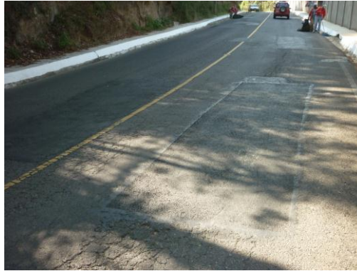
Figura 50. Est. 0+480, parches severidad media
