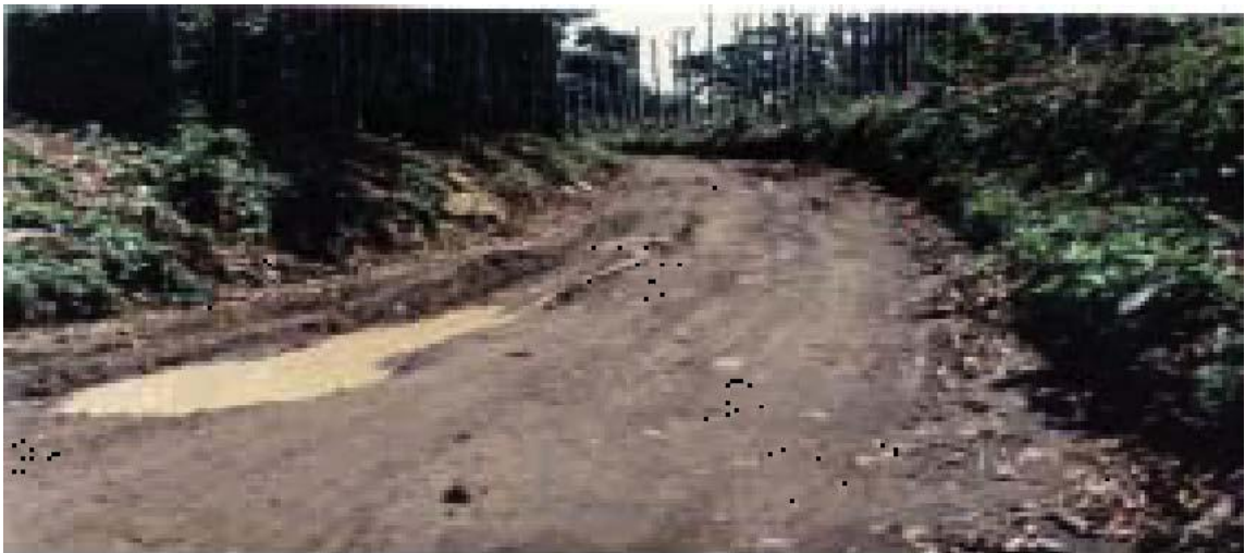
Figura 30. Pérdida sección transversal severidad alta
