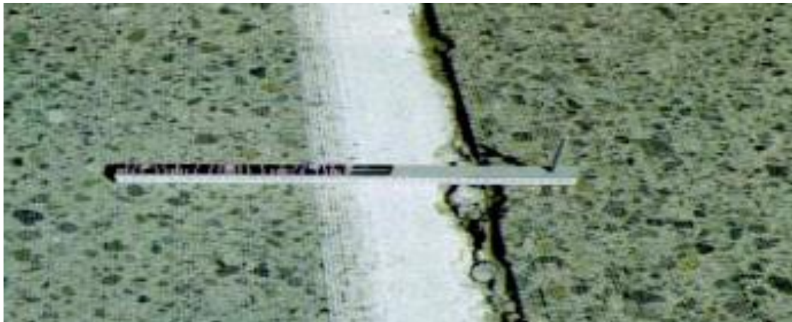
Figura 27. Despostillamiento severidad media
