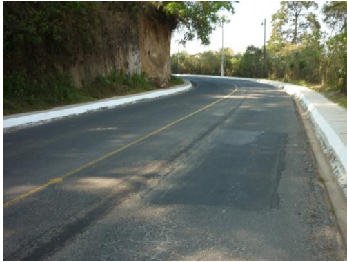
Figura 52. Est. 0+660, parche severidad media
