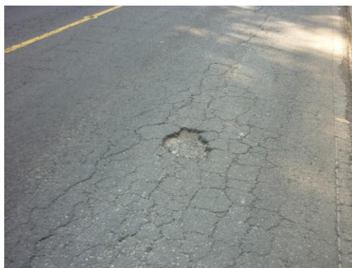
Figura 51. Est. 0+520, bache severidad baja
