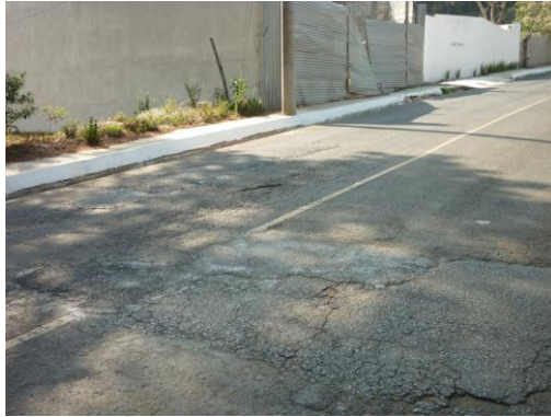
Figura 44. Est. 0+000, piel de lagarto y baches severidad alta
