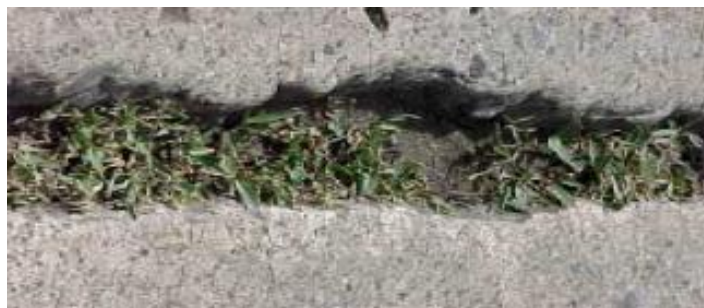
Figura 26. Deficiencia de material de sello severidad alta
