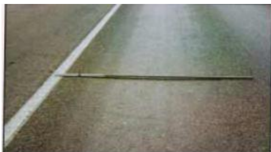
Figura 7. Ahuellamiento severidad media
