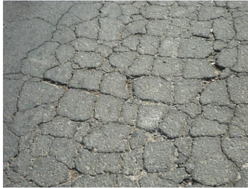
Figura 58. Est. 1+720, grietas en bloque severidad alta
