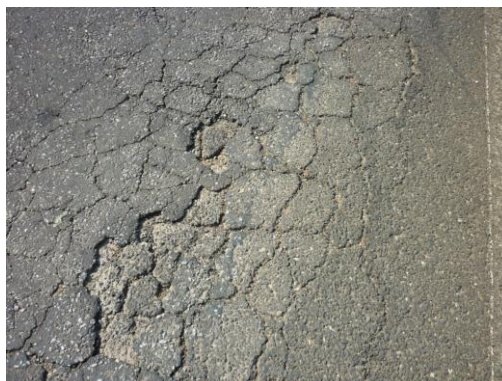
Figura 47. Est. 0+140, grietas en bloque severidad media
