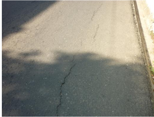
Figura 54. Est. 1+270, grieta longitudinal severidad media
