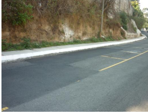
Figura 48. Est. 0+260, parches severidad media
