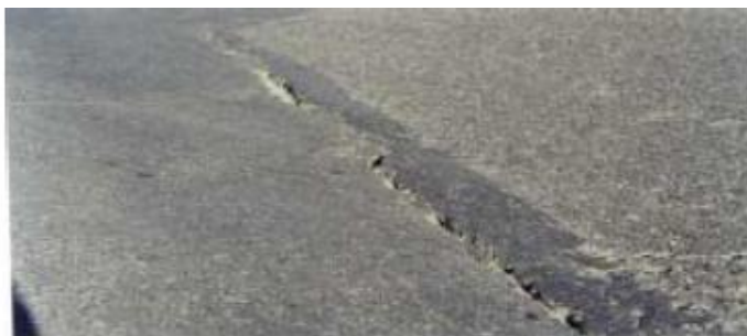
Figura 6. Fisura por reflexión de junta severidad media
