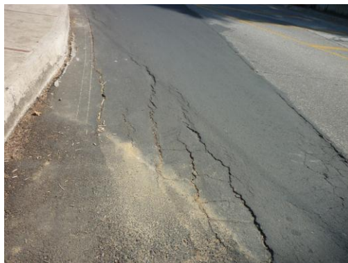
Figura 63. Est. 2+560, grieta longitudinal severidad alta
