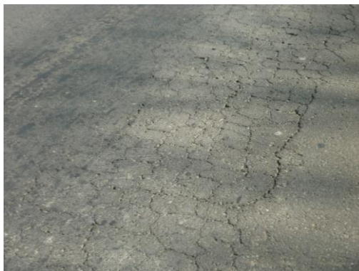
Figura 57. Est. 1+630, grietas en bloque severidad media
