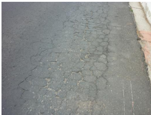
Figura 53. Est. 0+810, piel de cocodrilo severidad media
