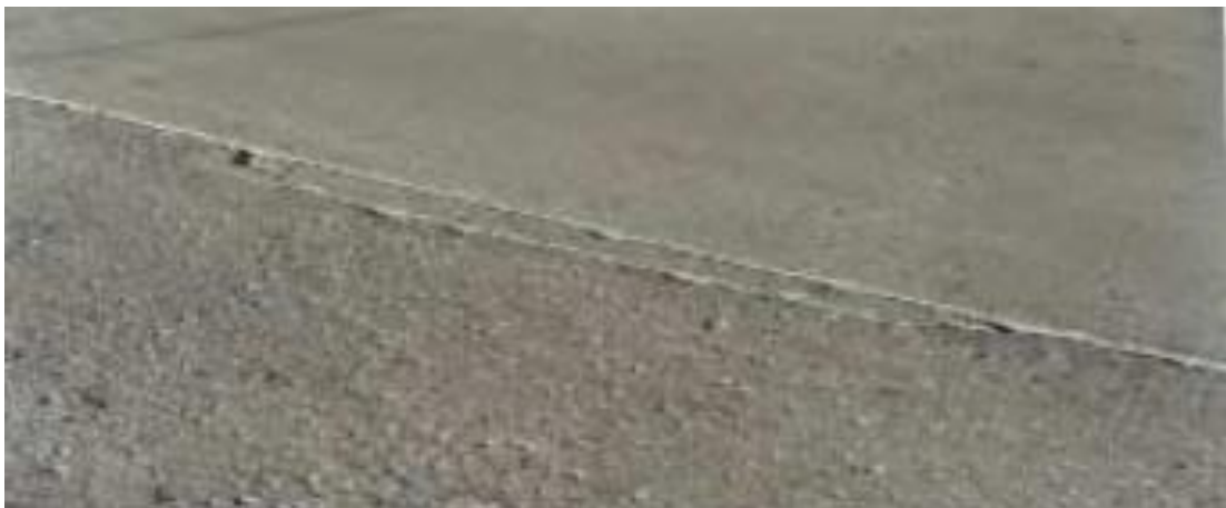
Figura 28. Fisuras por mal funcionamiento de juntas severidad media
