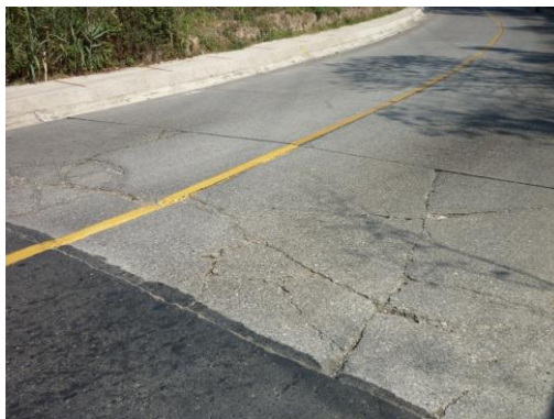
Figura 61. Est. 2+170, fractura de losa severidad alta
