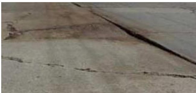
Figura 23. Hundimiento severidad alta
