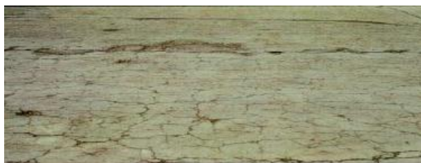
Figura 20. Fisuras en bloque severidad alta
