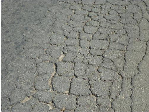
Figura 56. Est. 1+570, grietas en bloque severidad media
