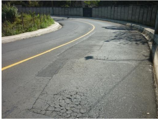
Figura 60. Est. 2+100, grietas en bloque y parches severidad alta
