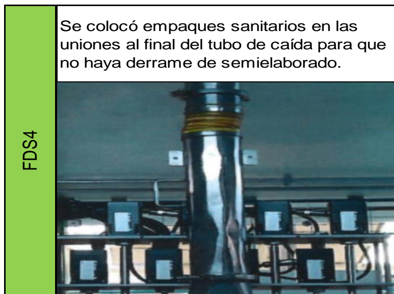
Figura 104. Mejora en fuente de suciedad # 4 de línea 1
