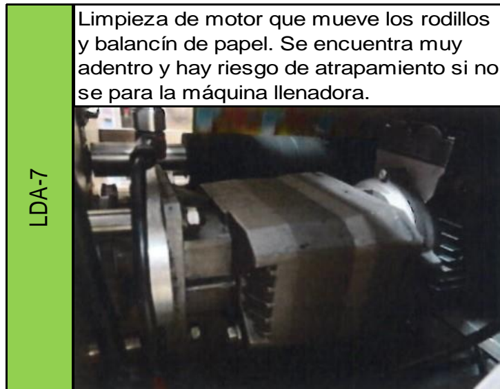
Figura 25. Lugar de difícil acceso a limpieza # 7 de línea 1
