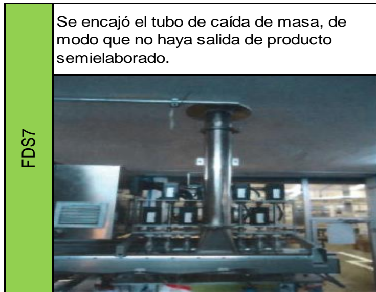
Figura 107. Mejora en fuente de suciedad # 7 de línea 1
