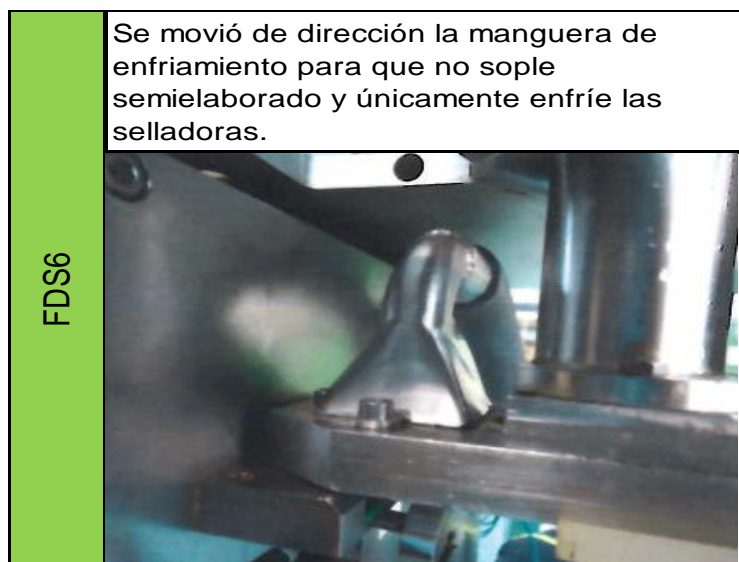
Figura 106. Mejora en fuente de suciedad # 6 de línea 1
