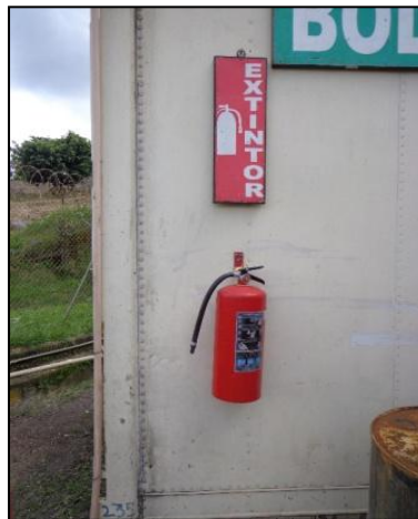
Figura 26. Señalización de extinguidores en área de lavado
