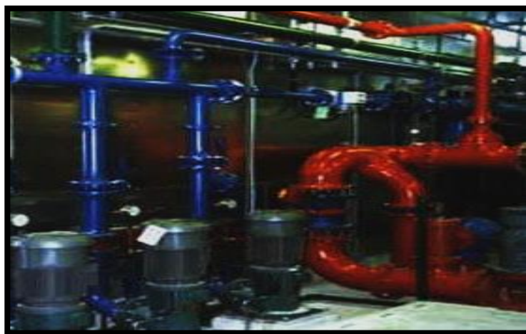
Figura 28. Tubería de gases y líquidos
