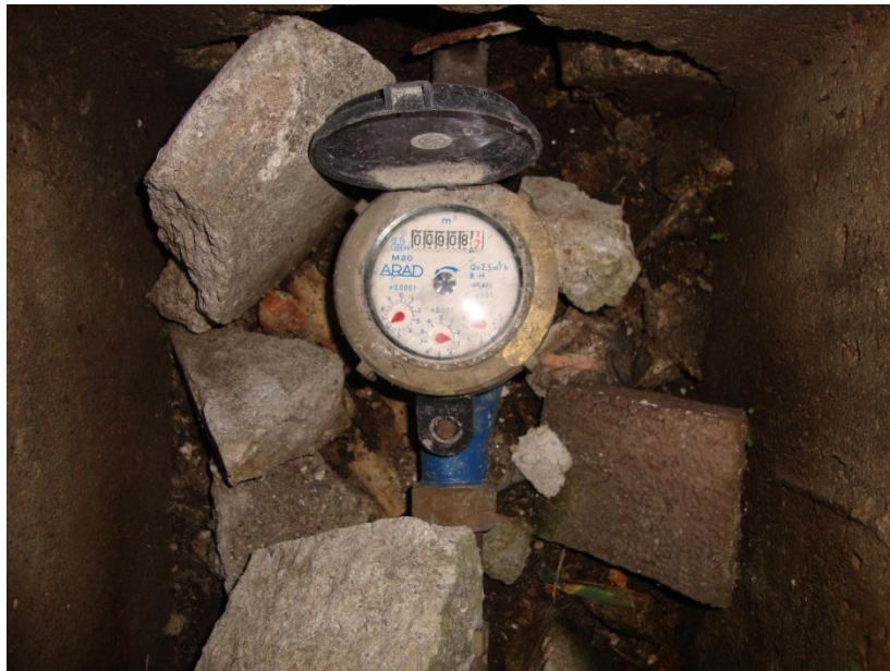
Figura 5. Medidor doméstico instalado en vivienda
