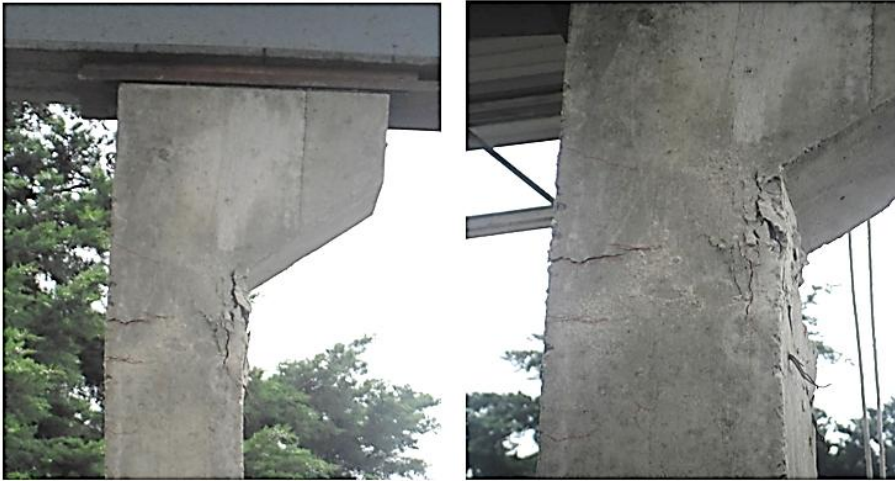
Figura 66. Fallas por tensión y compresión en columna 3
