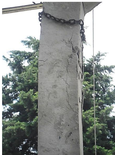
Figura 71. Descascaramiento y agrietamiento
