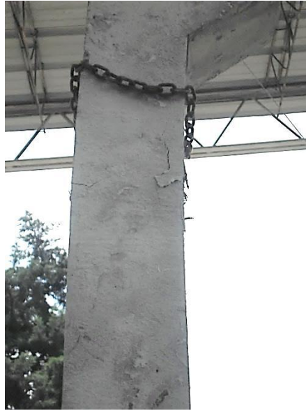
Figura 70. Fisuras en columna debida a las cargas
