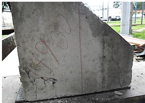
Figura 65. Aplastamiento en base de columna 3
