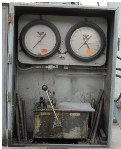
Figura 53. Escala y bomba de máquina hidráulica
