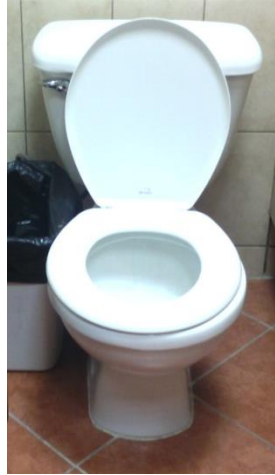
Figura 38. Inodoro del servicio sanitario de mujeres
