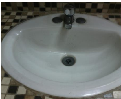
Figura 42. Lavamanos del servicio sanitario de hombres
