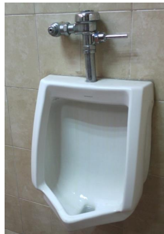
Figura 40. Mingitorio del servicio sanitario de hombres
