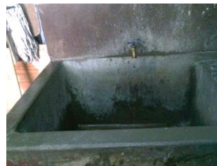
Figura 43. Pila para área mantenimiento
