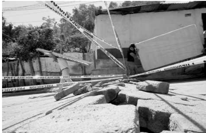
Figura 32. Imagen de problemática sucedida en Mixco por falla sísmica, grieta transversal a la calle
