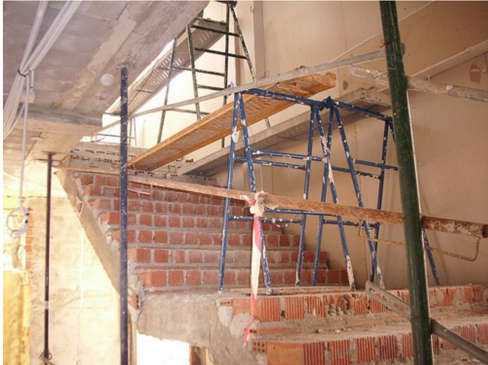
Figura 2. Condición insegura en la construcción
