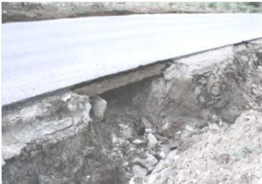
Figura 17. La capa estabilizada con cal soporta la erosión, ilustrando la resistencia
