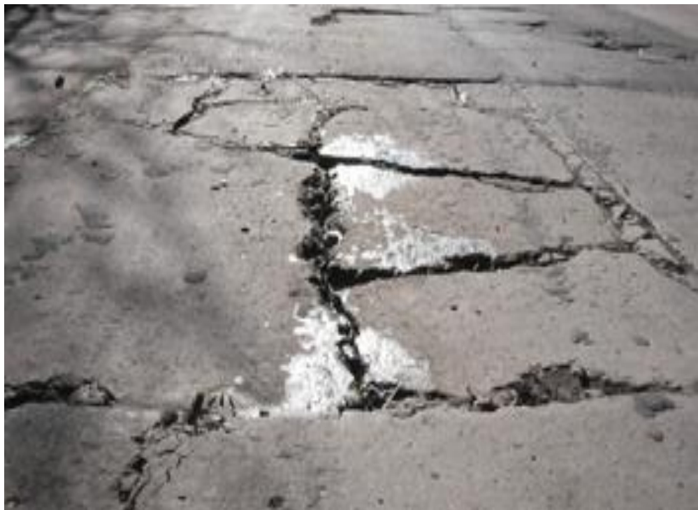
Figura 15. Ejemplo extremo de fracaso de un pavimento por suelos inestables
