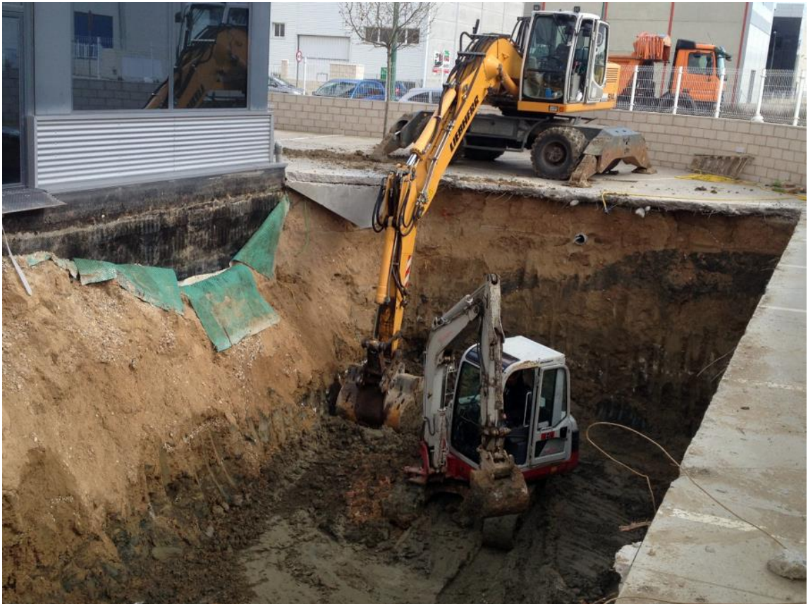
Figura 39. Protección para la caída de terreno suelto
