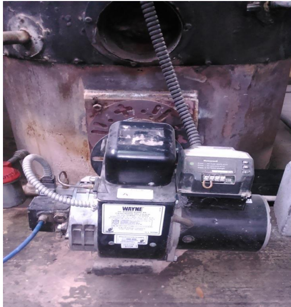
Figura 9. Quemador de caldera
