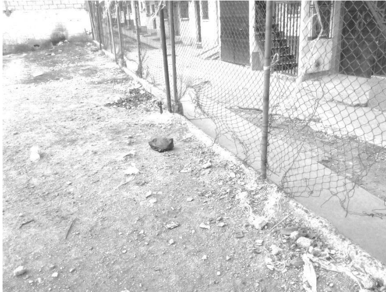
Figura 3. Daño en red perimetral
