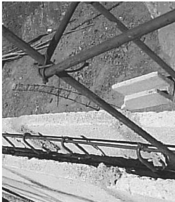
Figura 15. Mala práctica por cambio de calidad del refuerzo longitudinal
