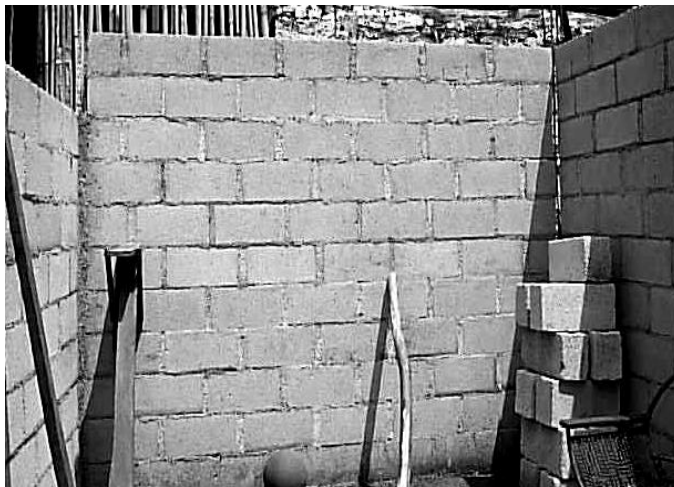
Figura 13. Juntas no uniformes y mala calidad de acabado final
