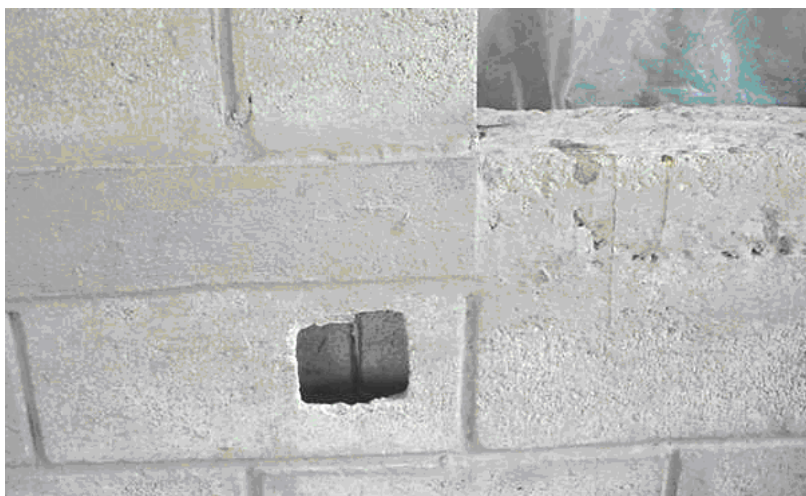
Figura 10. Pin que no fue fundido, ni detectado por el supervisor
