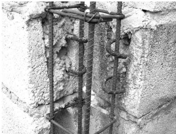
Figura 14. Armadura que no cumple con especificaciones
