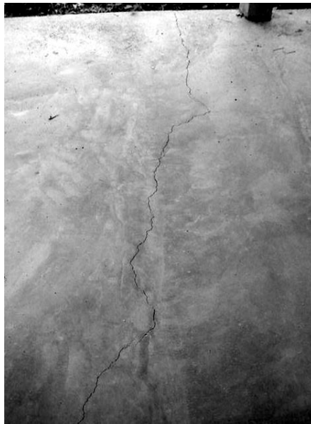
Figura 12. Piso agrietado que no cumple con especificaciones
