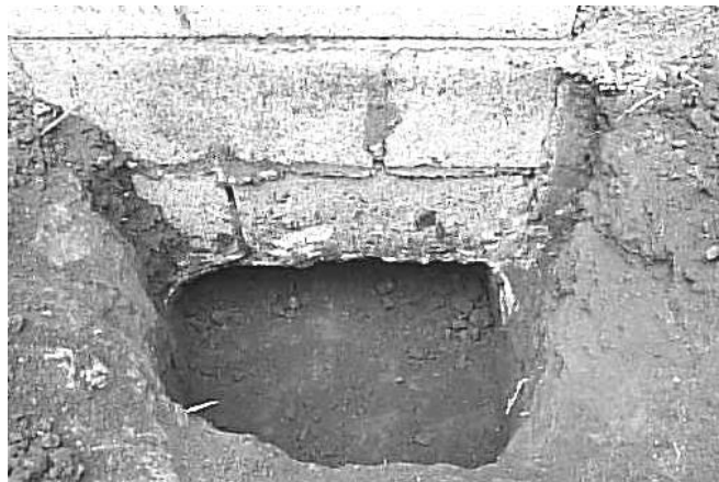
Figura 8. Cambios para disminuir la cantidad y calidad, falta de cemento
