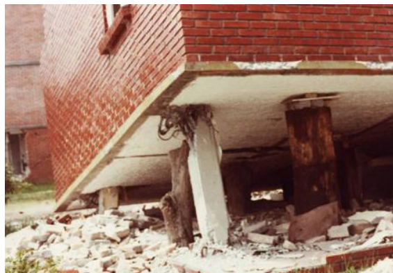
Figura 30. Colapso total en Popayán, Colombia 1983
