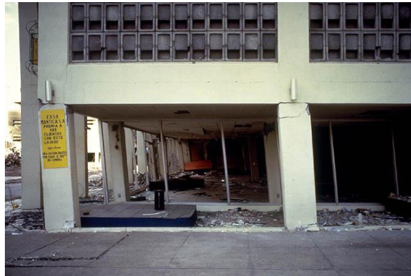
Figura 29. Colapso parcial en Managua, Nicaragua 2000
