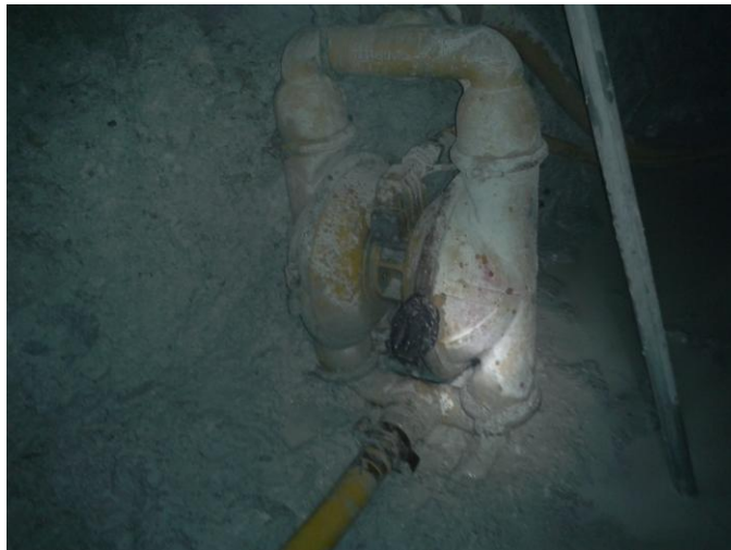
Figura 22. Bomba extractora de agua
