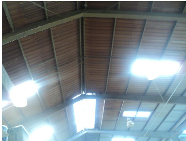
Figura 12. Daño a la infraestructura del techo en el área de compactado de esponja
