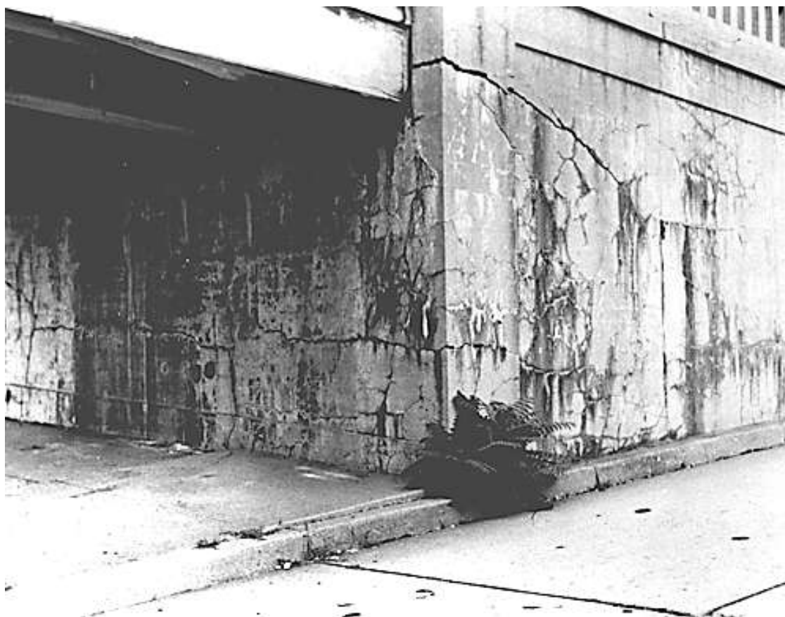
Figura 2. Formación de grietas causadas por la expansión anormal debido a la reacción álcali-agregados
