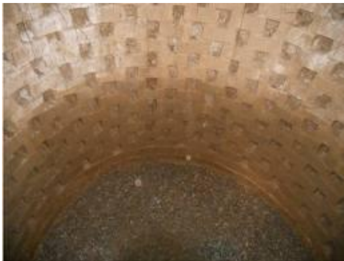
Figura 9. Pozo de absorción de agua de lluvia
