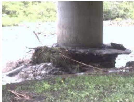
Figura 7. Daños a la base de un puente
