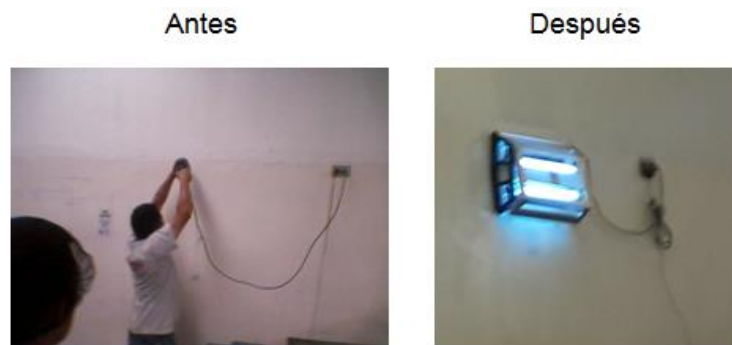
Figura 46. Colocación de lámparas ultravioleta
