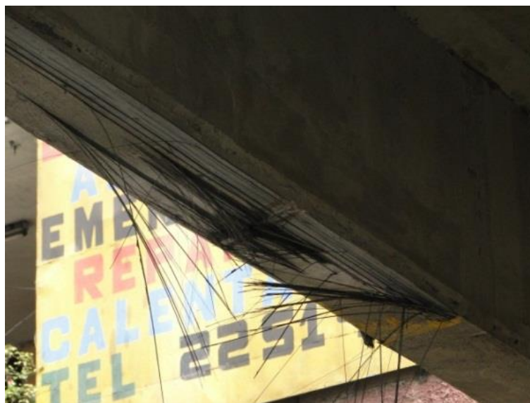
Figura 40. Daño de refuerzo CFRP
