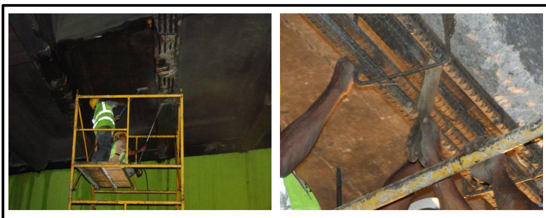
Figura 44. Limpieza de suciedad y remoción del óxido.
