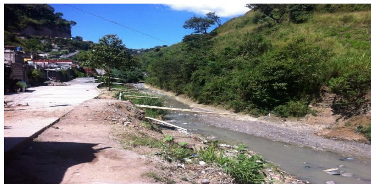
Figura 11. Detección de necesidad de un muro de gaviones
