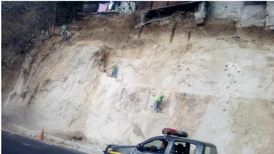
Figura 5. Desgaste del talud
