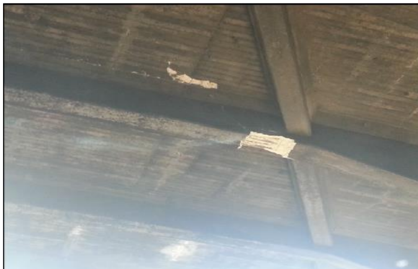
Figura 15. Detección de falla en puente
