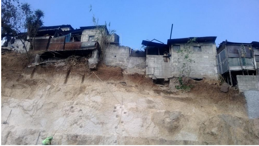
Figura 4. Detección de necesidad de recubrimiento de talud
