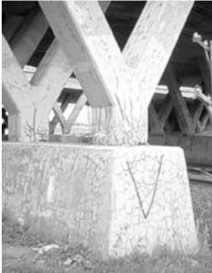
Figura 23. Daño en estructura de concreto por reacción álcali-agregado
