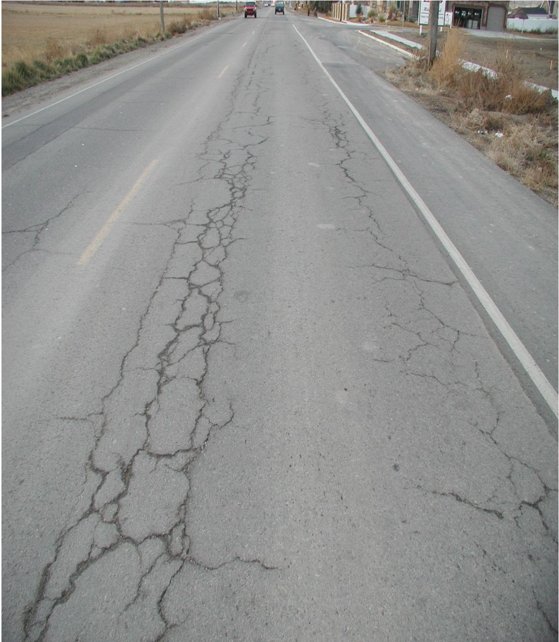
Figura 1. Daños en carretera de pavimento asfáltico
