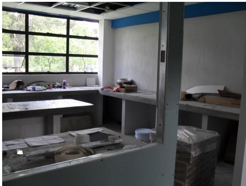
Figura 13. Interior del nuevo Laboratorio de Asfaltos
