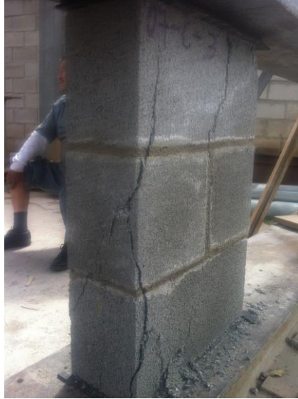
Figura 68. Falla de cono en prismas de compresión
