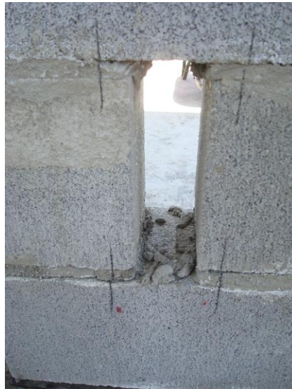
Figura 93. Corrimiento en los prismas de adherencia
