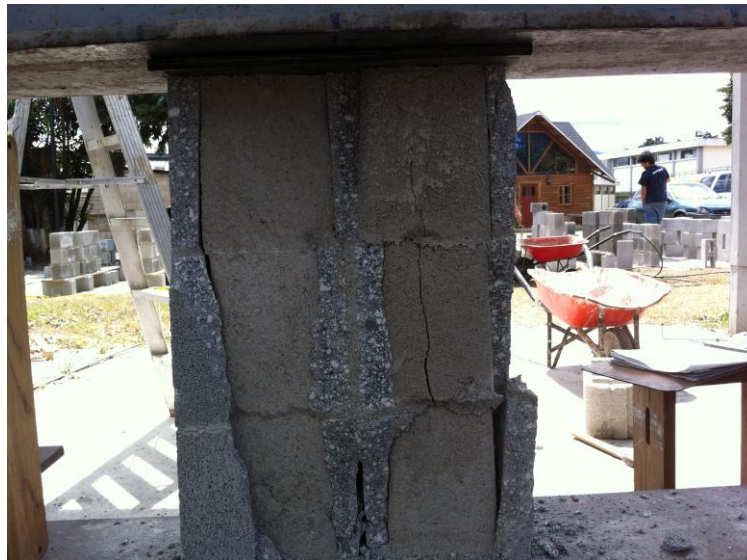
Figura 67. Falla en el grout de la mampostería llena
