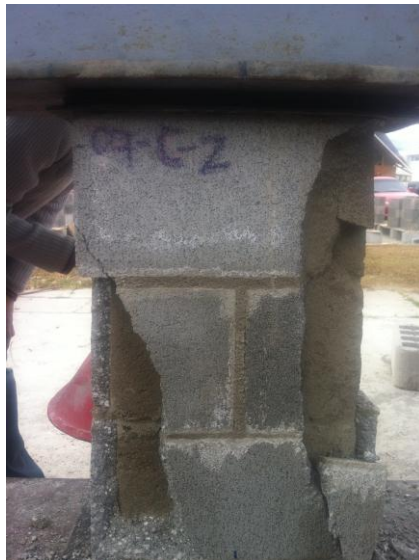
Figura 69. Falla por desprendimiento del cascaron en prismas llenos
