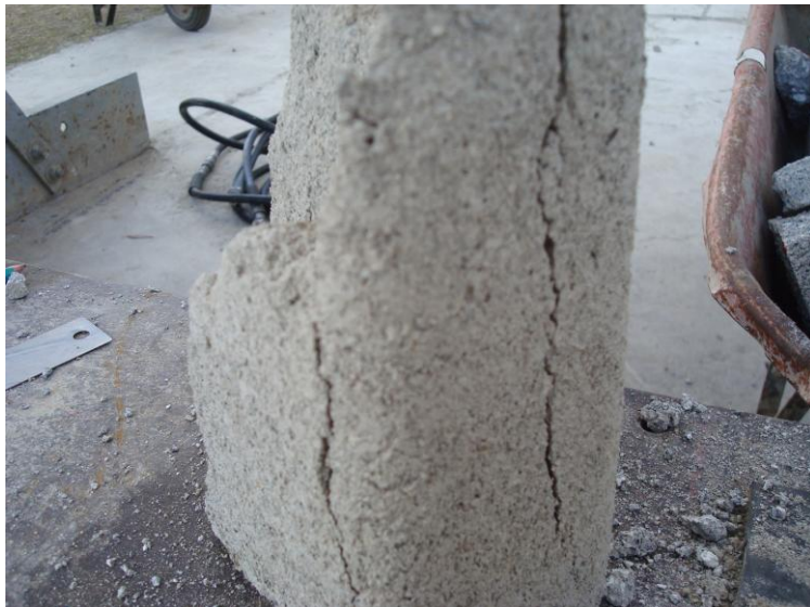
Figura 73. Falla en el grout
