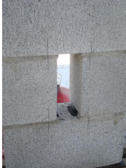
Figura 92. Corrimiento en los prismas de adherencia
