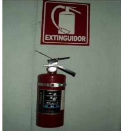
Figura 16. Extintor ubicado en el área de operaciones
