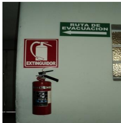
Figura 17. Extintor ubicado en el área de sala de juntas
