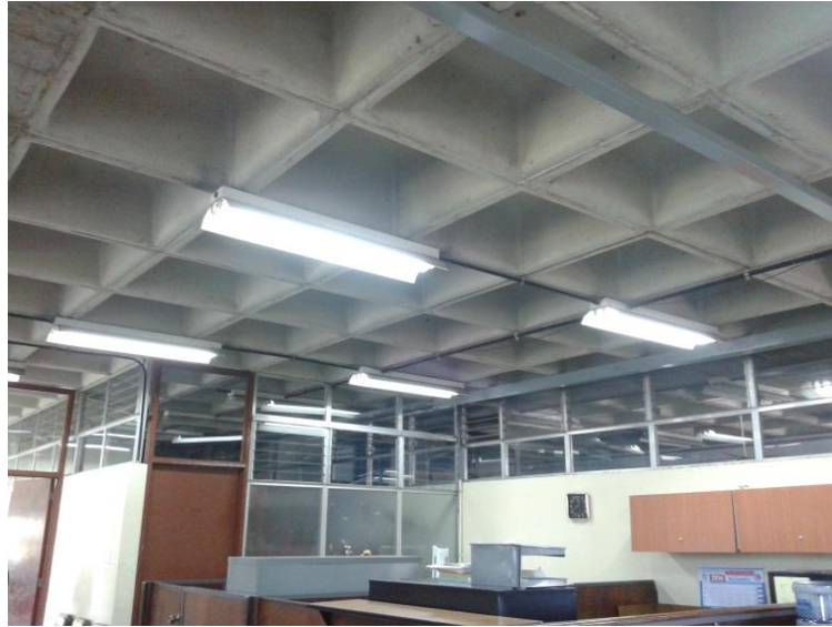
Figura 19. Luminarias en el área de secretarías
