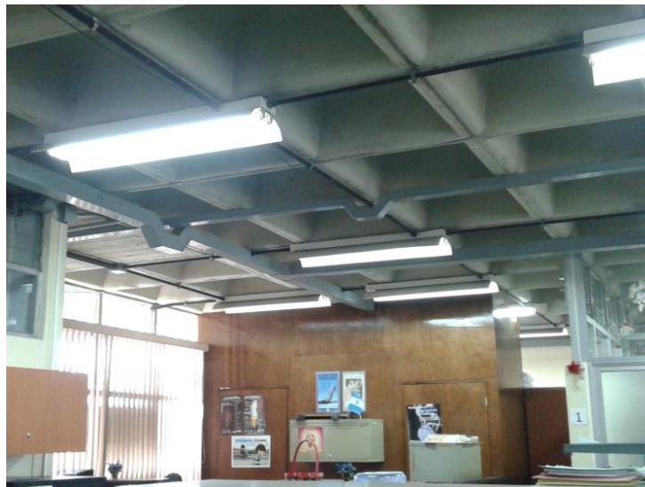
Figura 20. Luminarias en el área de recepción
