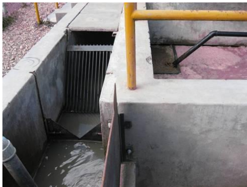
Figura 18. Canal de rejas actual de la planta
