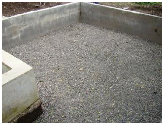
Figura 21. Patio de secado de lodos
