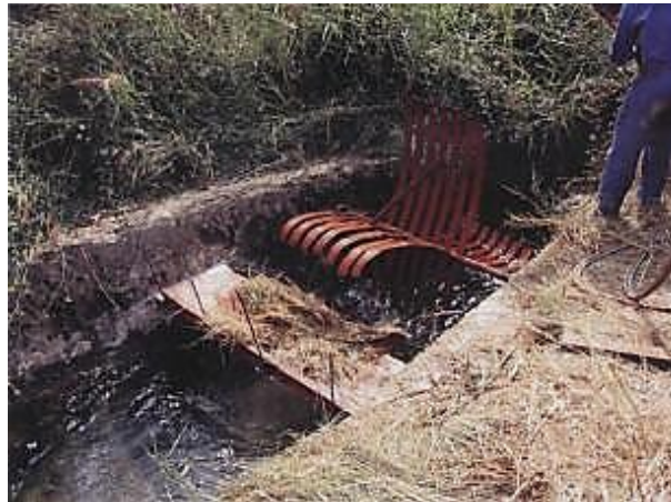
Figura 8. Canal de rejas
