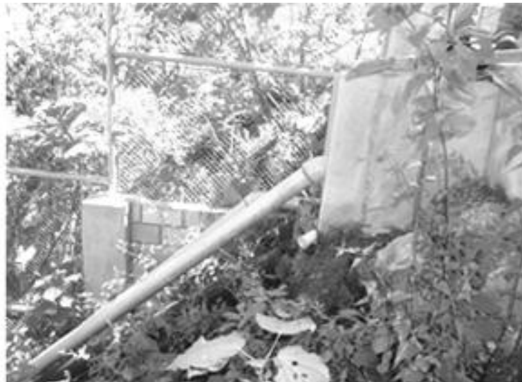
Figura 9. Línea de distribución, tubería de 4" de diámetro
