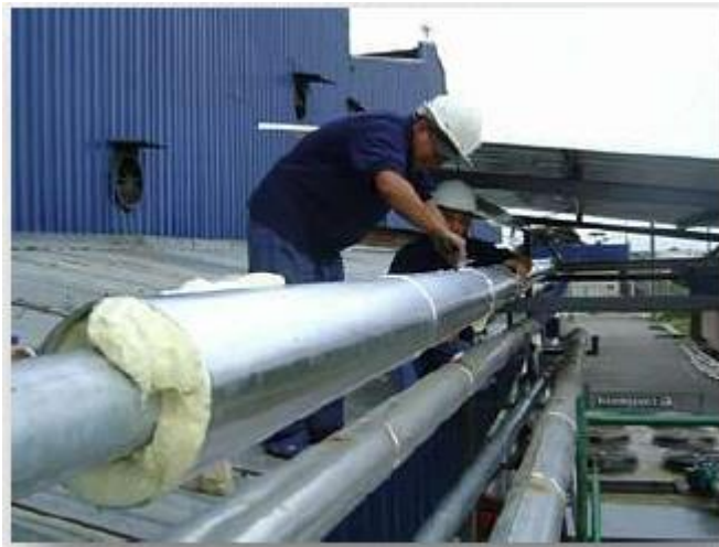
Figura 16. Tubería con aislamiento térmico
